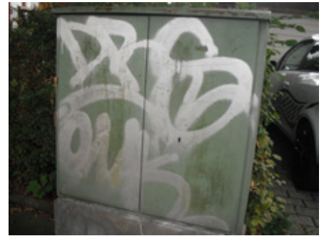
☹️ häßlicher rostiger Stromkasten in der Stellichter Straße (16)
